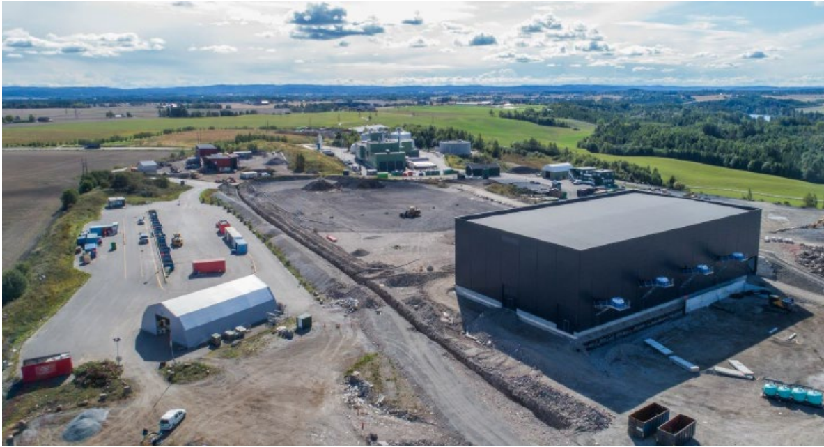
Figur 5. Gjenvinningsanlegget til AF Decom på Nes på Romerike (AF Decom, 2019)
